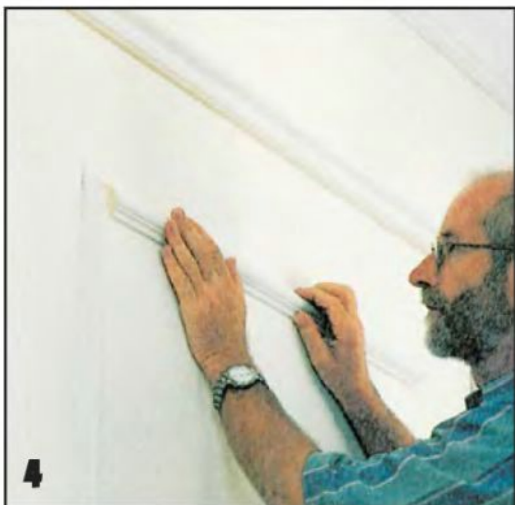
Раскроив профили для внутренней рамки, их на монтажном клее крепят к стене в помеченных карандашом местах.
